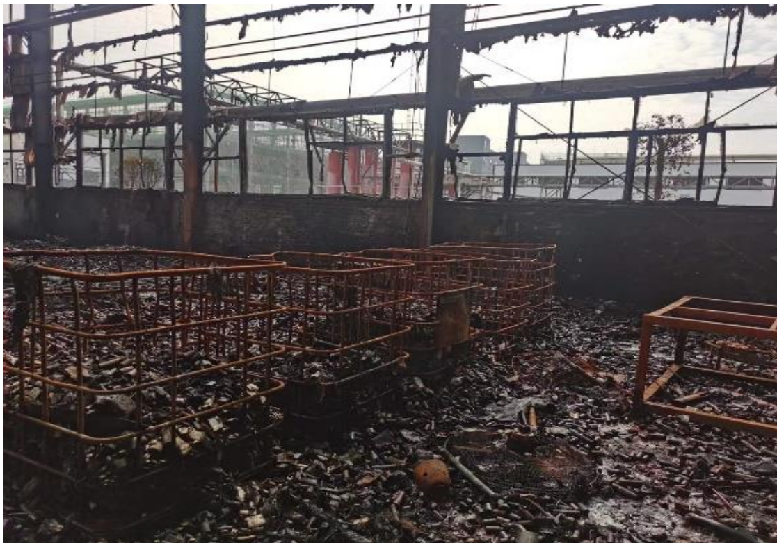
图六 事故现场照片
